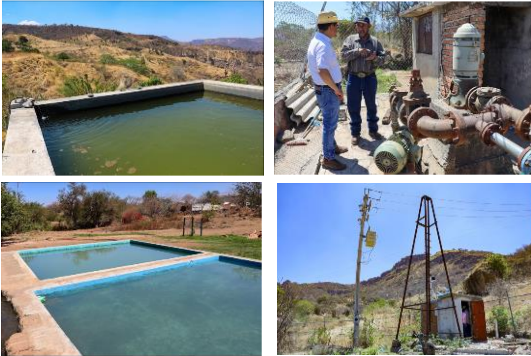
Imagen 4.8. Microred eléctrica para bombeo de agua
